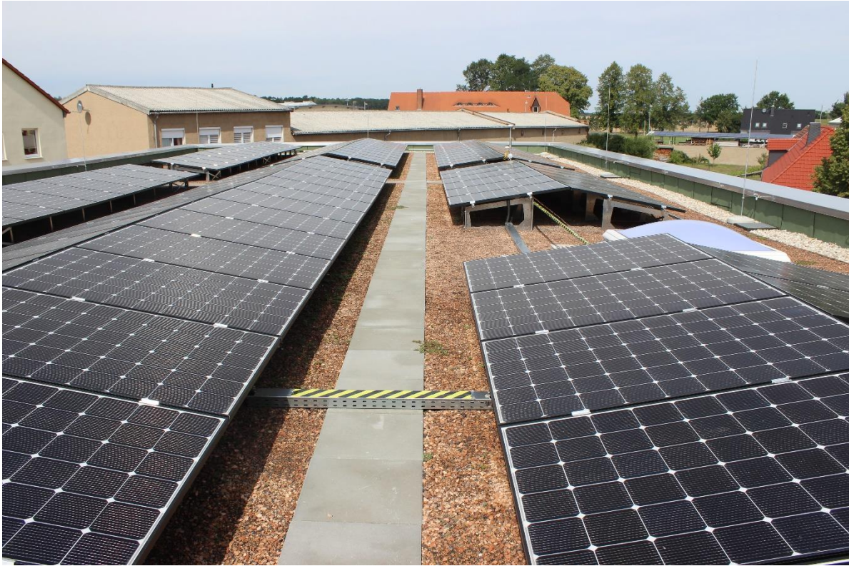
Abbildung 2: Solarpaneele auf dem Flachdach
