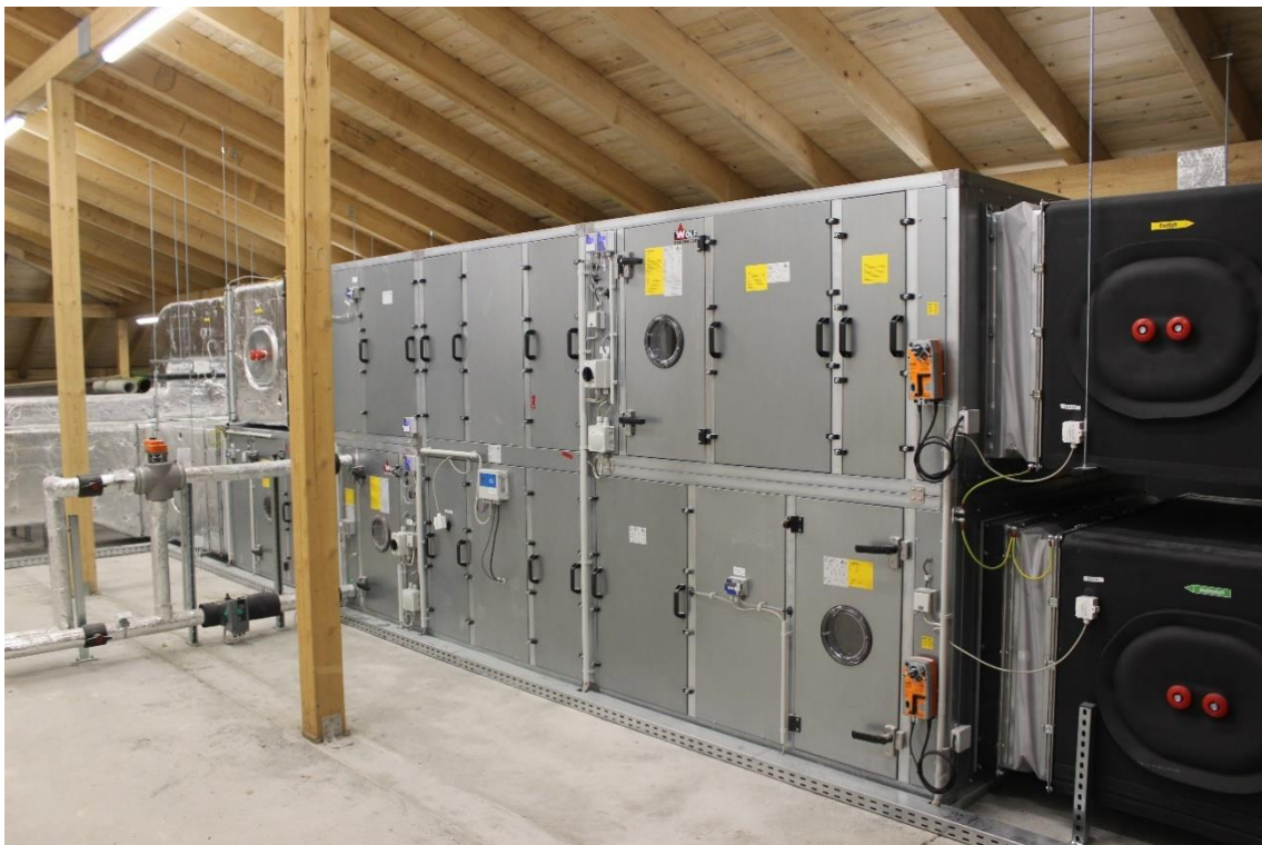
Abbildung 4: Lüftungsanlage unter dem Kaltdach
