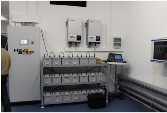
Abbildung 1: v. li.: Schaltschrank Gebäudeleittechnik-Anlage mit Wechselrichter des Batteriespeichers, Batteriespeicher, 2 von 4 Wechselrichtern der Photovoltaik-Anlage, Messrechner
