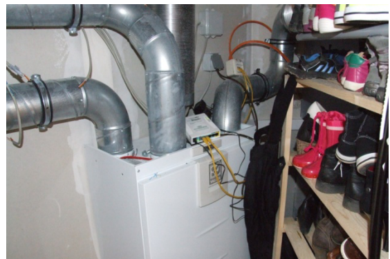
Abbildung 4: Lüftungsanlage mit Wärmerückgewinnung
