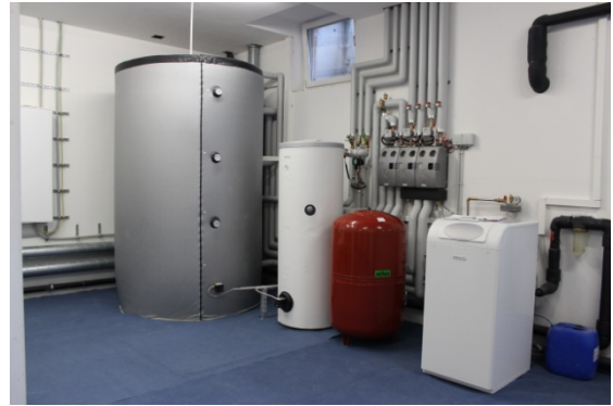
Abbildung 2: v. li.: 5.000 l Heizungspufferspeicher, 440 l Trinkwarmwasserspeicher, Membranausdehnungsgefäß, Grundwasser-Wärmepumpe
